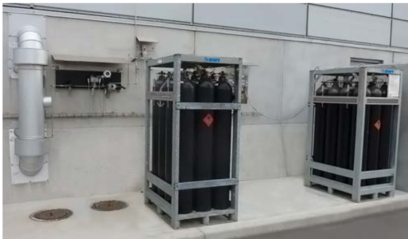
Brintstationen placeres uden for bygningen.
