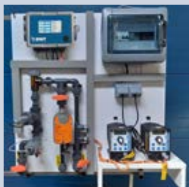
Koeltoren: dosering, meting, regeling en afstandsbediening via modem
