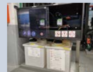
Meting, dosering en regeling van glycolwatercircuits – Pharma-processen
