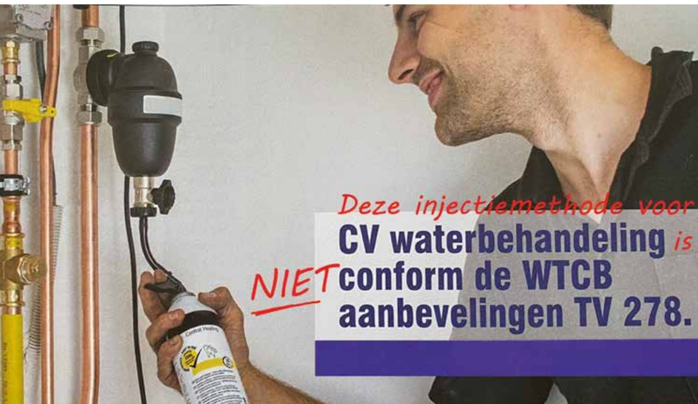
Injectie van een patroon is niet conform de WTCB richtlijn TV 278
